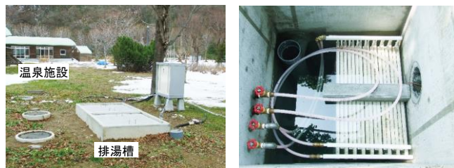
排湯槽と槽内の熱交換器の外観
