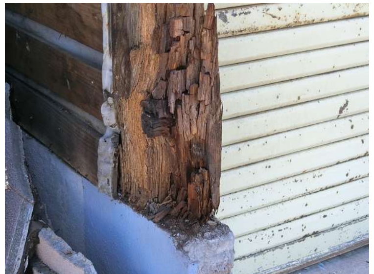
写真3 柱脚の激しい腐朽
