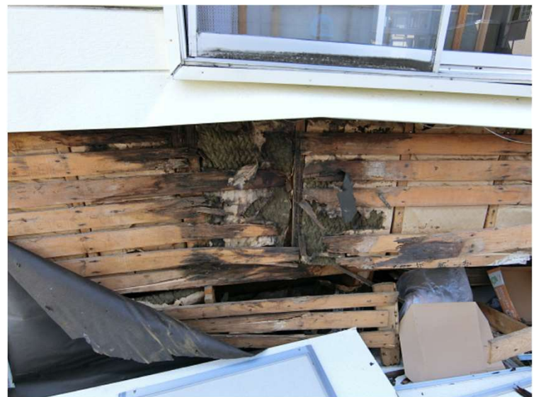
写真2 開口下部の下地板の腐朽
