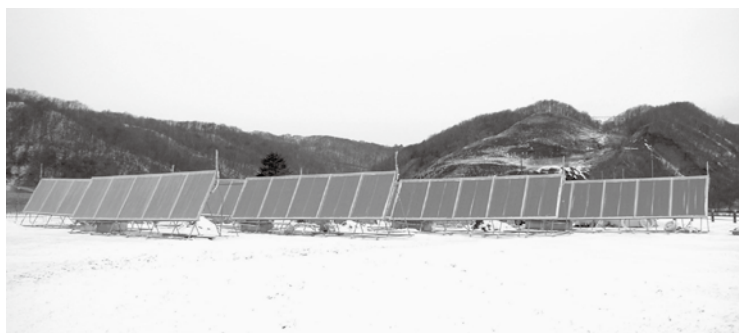
大型樹脂パイプ集熱器の全景
