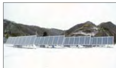
大型樹脂パイプ集熱器の全景
