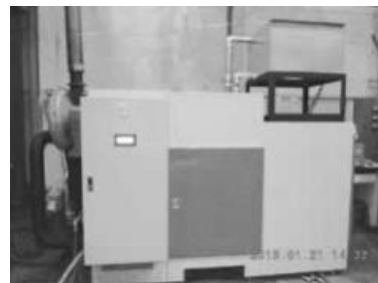
ポリスチレンペレット燃焼ボイラー
