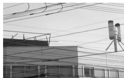
社屋上に設置された太陽光と風力発電
