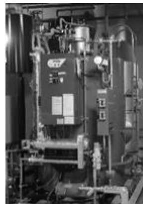
稼働中のボイラ
