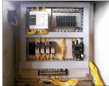
制御装置を交換した制御盤内部の様子
