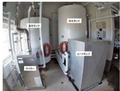
実証試験システムの外観
