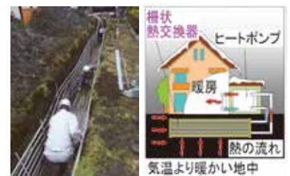
写真④ プラスチック製の槽状熱交換器を利用した地中熱利用システム
