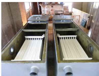
温泉水導入前の樹脂製熱交換器
