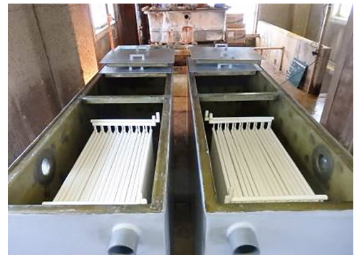
温泉水導入前の樹脂製熱交換器
