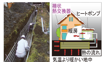
写真④ プラスチック製の棚状熱交換器を利用した地中熱利用システム
