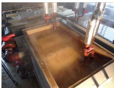
温泉水浸漬後の樹脂製熱交換器
