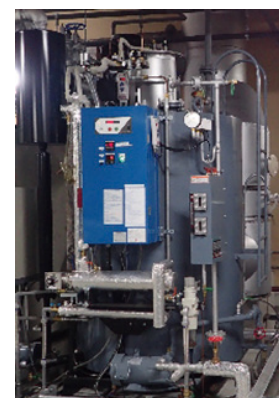
図3 稼働中のボイラ
