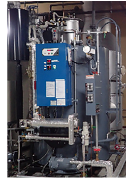
稼働中のボイラ
