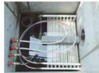
排湯槽(上)と槽内に設置した樹脂製柵状熱交換器の外観
