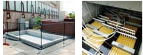
排湯槽及び排湯槽内に設置した給湯予熱用熱交換器の外観
