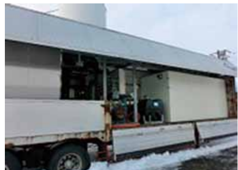
各装置を収納したコンテナ
