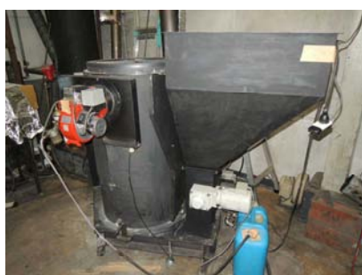
ポリスチレンペレット燃焼装置
