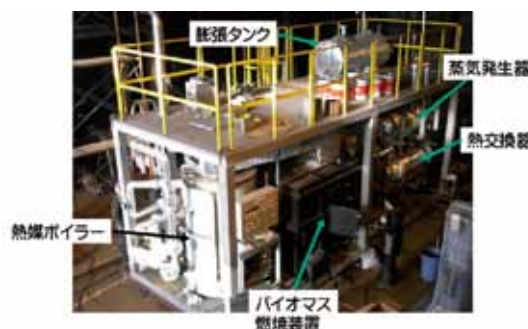
木質バイオマス燃焼熱媒ボイラー
