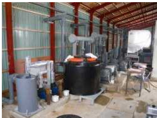
実浄化装置機械室
