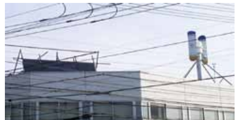
社屋上に設置された太陽光と風力発電
