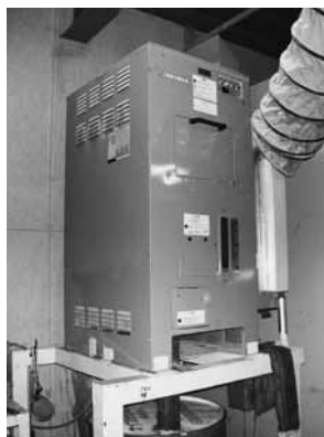
廃不凍液濃縮機
