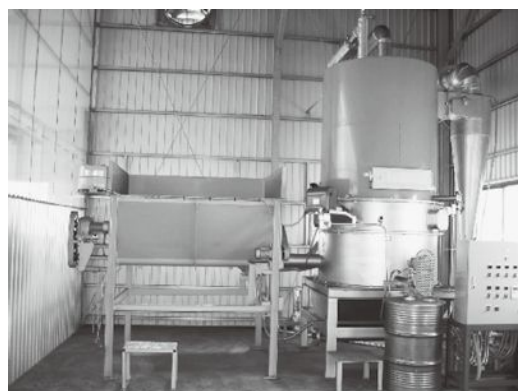
廃菌床を燃料としたボイラー
