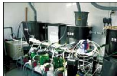
脱窒処理プラント
