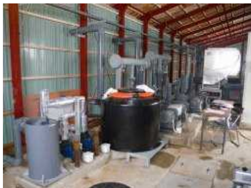
実浄化装置機械室
