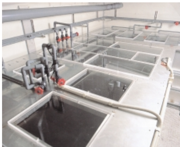
図6 実規模浄化循環システム内部
