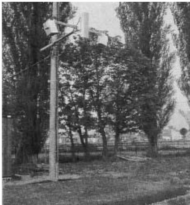
図2 工試構内試験システム全景
