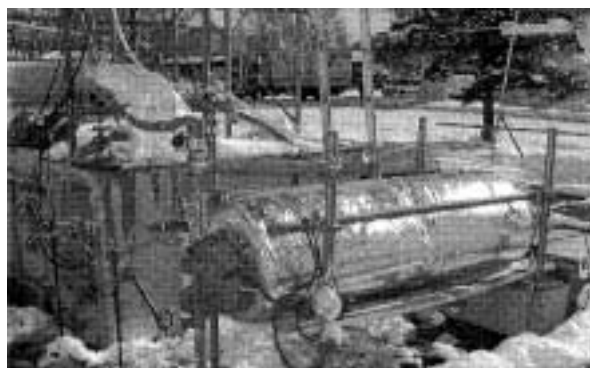
図3.4 下水採熱管の熱交換性能実験の外観
