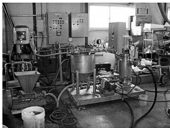
図2.1 脱脂システムの外観
