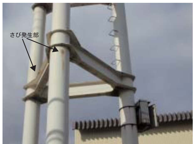
図5 広告塔で観察されたさび
