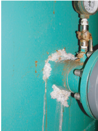
図1 温泉水貯湯タンクでの漏水発生事例
