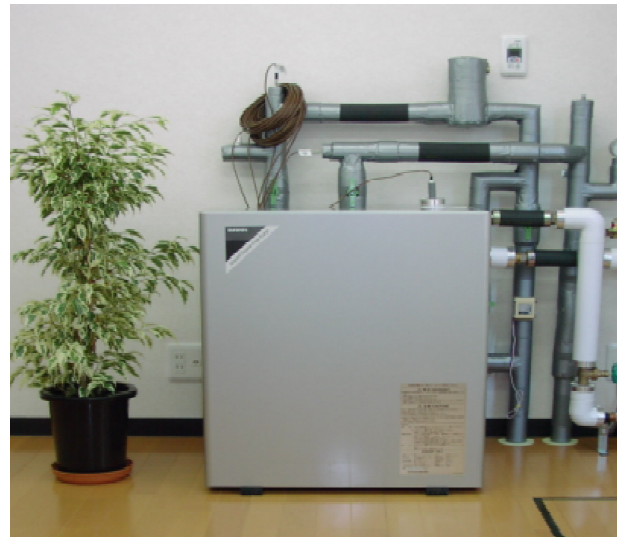
写真4 床暖房用ヒートポンプ及び配管
