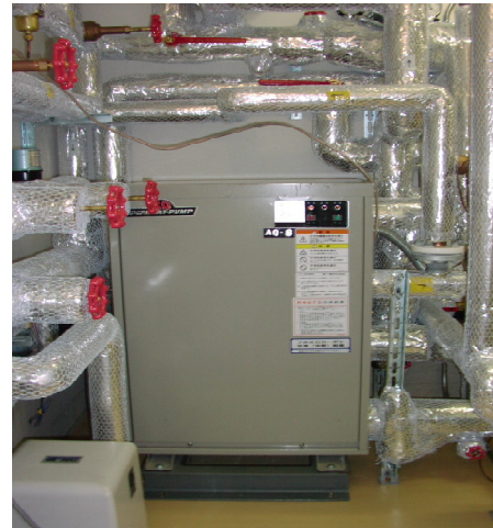
写真5 ロードヒーティング用ヒートポンプ
