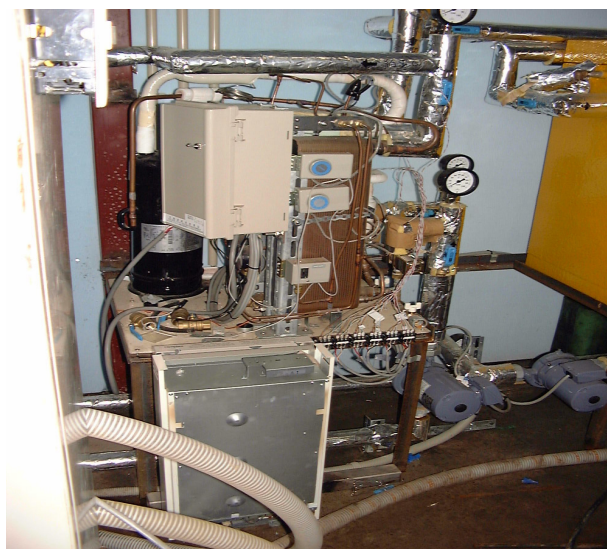
写真12 ヒートポンプ
