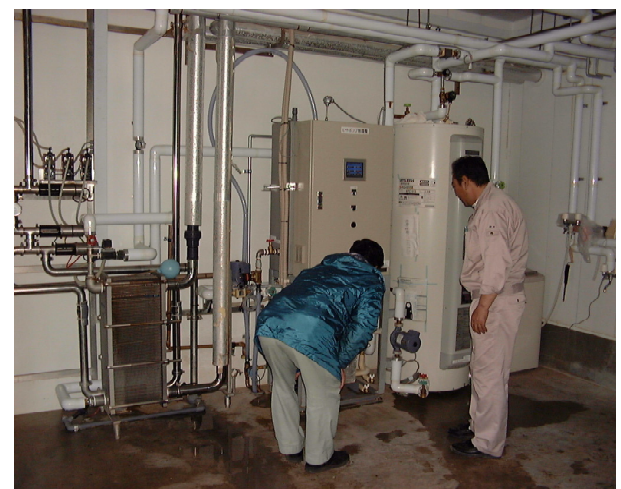
写真16 牧場に設置したヒートポンプ
