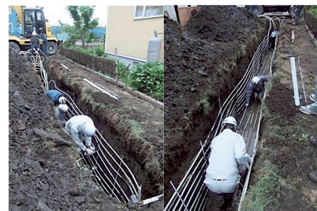
図17 柵状熱交換器の設置状況
