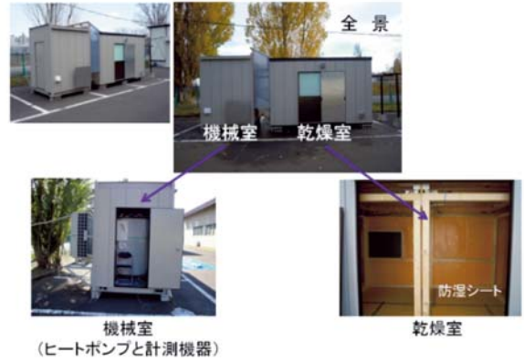
図19 実証プラントの外観
