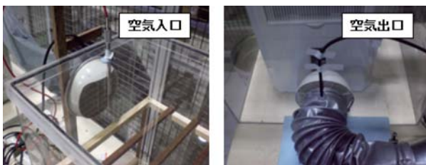
図7 乾燥ボックス内空気入口・出口の様子
