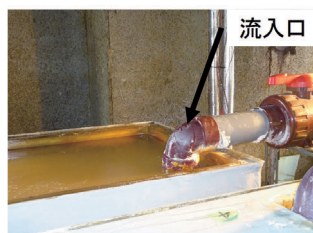
図10 本施設における温泉水の熱交換槽への流入
