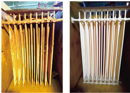
図18 濃塩酸水によるスケールの溶解
