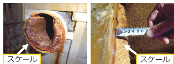
図1 配管・温泉槽の壁へ固着したスケールの外観
