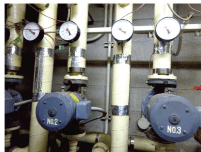
(b) 系統の配管表面温度計測
