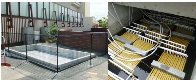
排湯槽及び排湯槽内に設置した給湯予熱用熱交換器の外観
