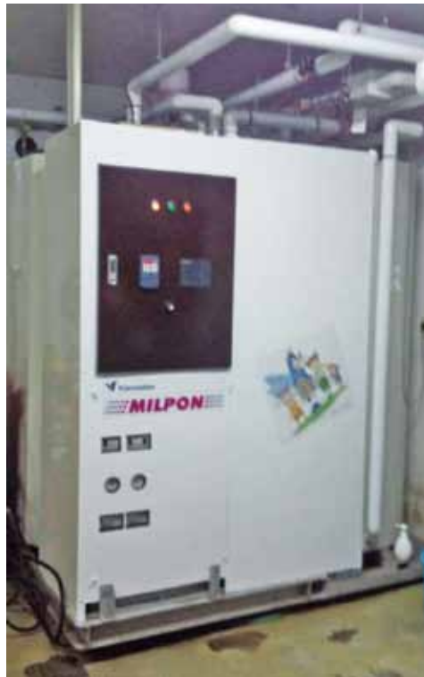
氷蓄熱ヒートポンプ給湯システムの外観
