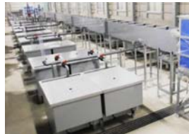
図3 (一社)北見管内さけ・ます増殖事業協会 興部第二ふ化場
