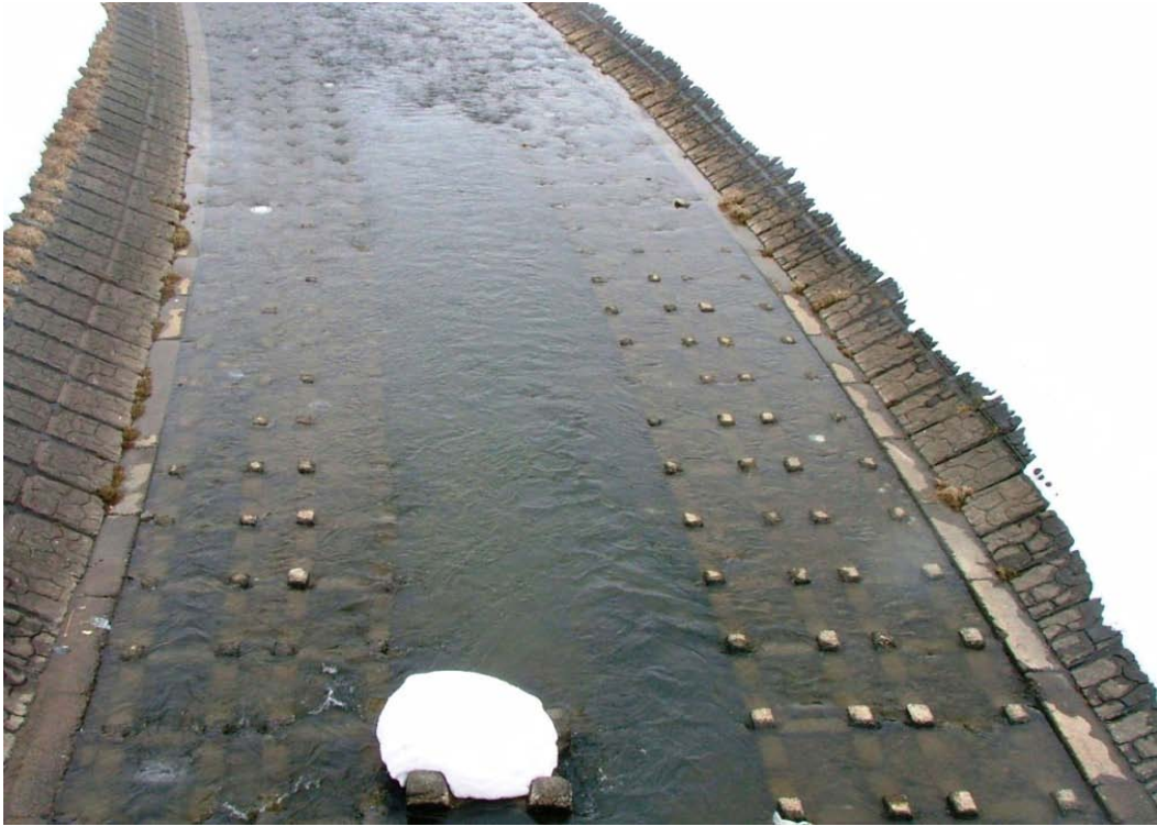
図 4 河岸と河床の状態 両岸は護岸が行われ河床にはブロックが置かれているが、河床自体は砂れき底
