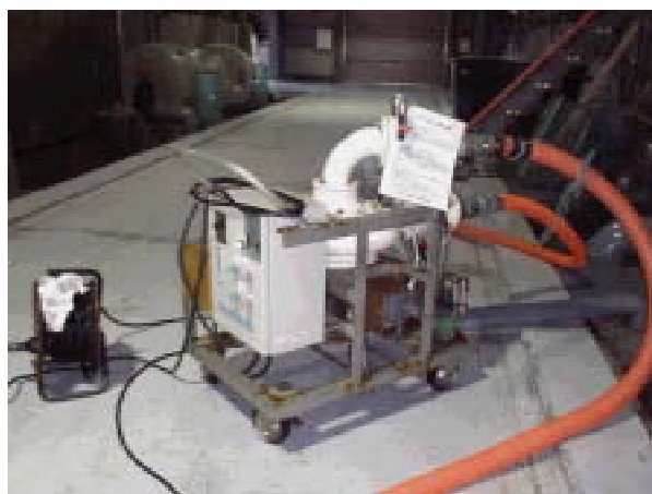
写真 種苗移送ポンプ
