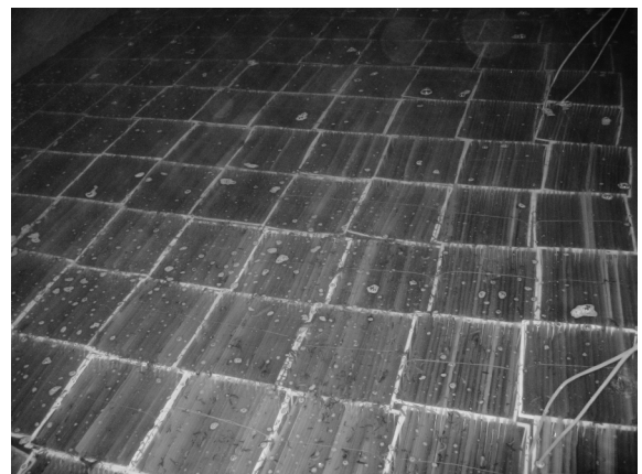
写真8 水槽底面の様子 12×17枠設置されている
