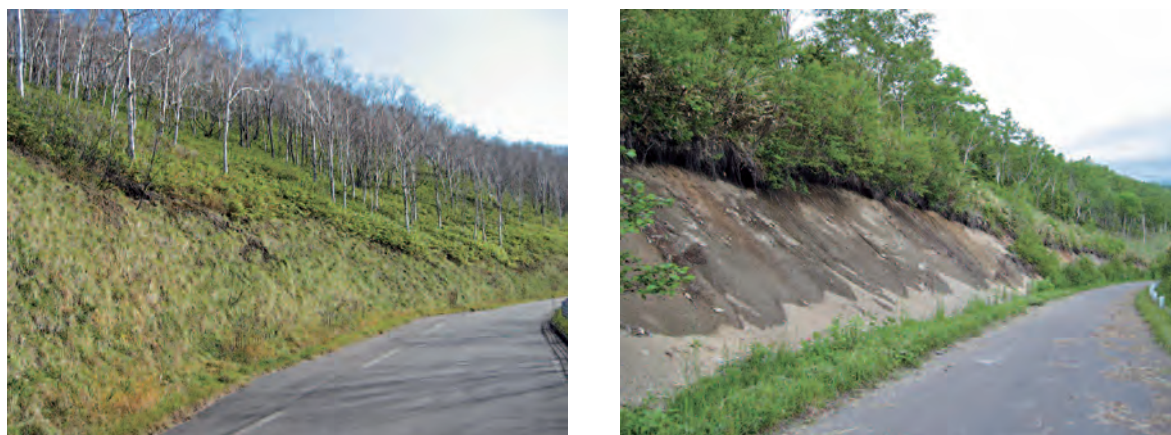
写真－1 同一路線内の林道において、ササが被覆するのり面（左）と、ササの被覆が無い箇所に雨で流亡したのり面（右）
