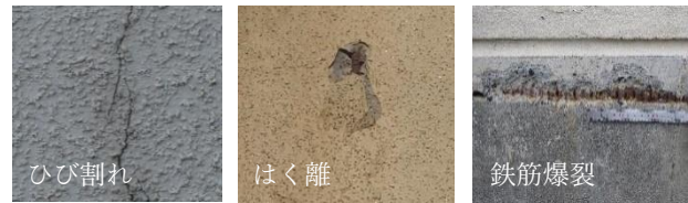
図 1-1 外壁劣化の代表例
