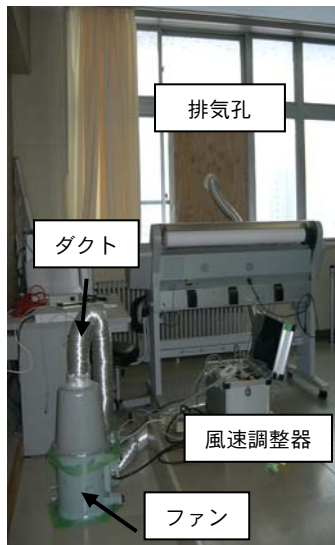
写真7 換気装置の外観
