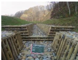
間伐材等を利用した流路工 (公共土木事業における間伐材等の利用推進)
