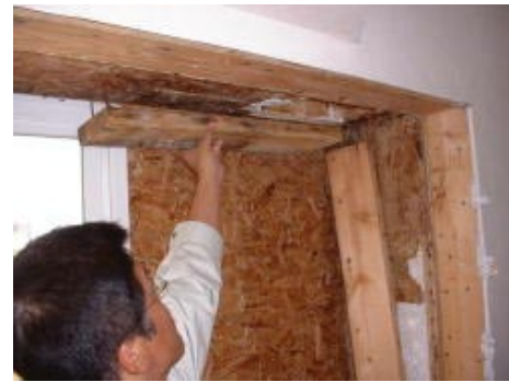
写真9 窓枠部材 (室内側) ※高含水率状態にあるが腐朽はしていない
