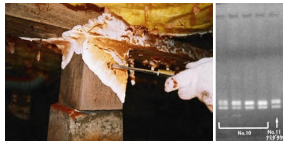
写真3 床下腐朽（左）とDNAによる腐朽菌の同定（右）
