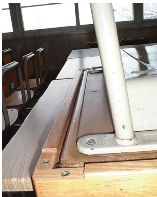
写真2 机天板（裏面）と金具取付部
