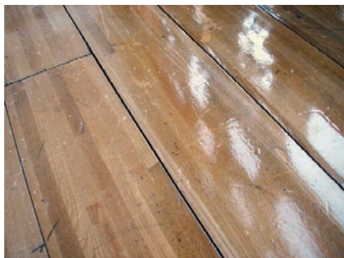
写真1 フローリングの合わせ目に生じたすき間
