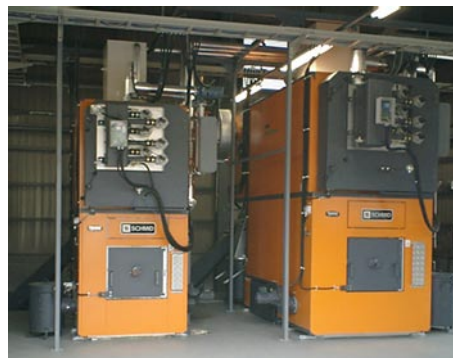
写真2 チップボイラ
