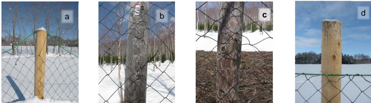
写真-1 確認されたネットの損傷の種類
