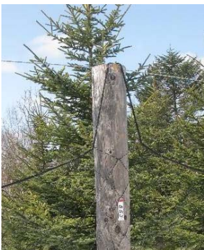
写真2 積雪荷重を受けて伸張したゴムロープ
