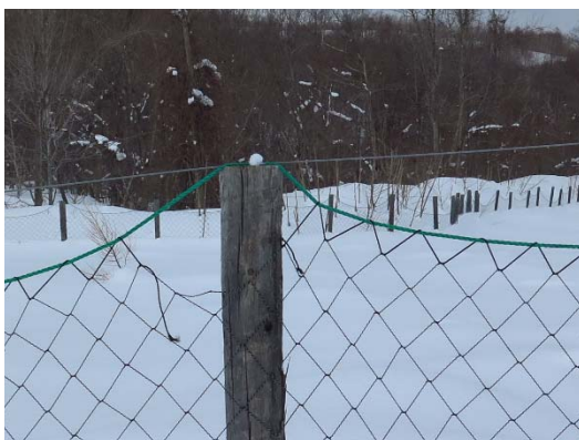
写真-2 木口面に設置した場合の破網状態。
