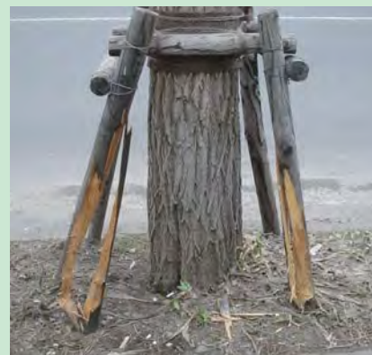
④ 支柱の損傷
