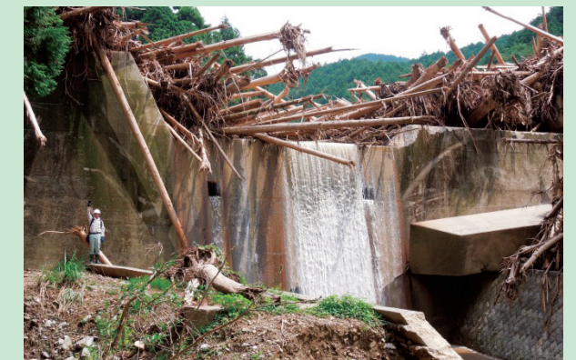
写真-3 流木の流下を阻むダム
