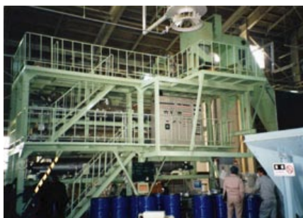
写真1 熱処理装置1号機
