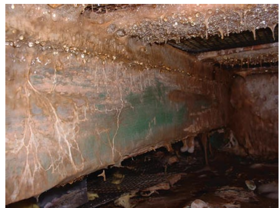
写真1 腐朽菌が蔓延した住宅床下の様子
