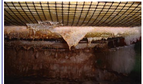
写真1 住宅に発生した腐朽被害
