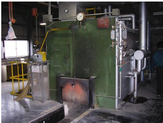
写真1 木屑だきボイラー（道内S社）
