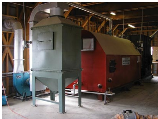
写真 3 木屑だきボイラー（下川町森林組合）
